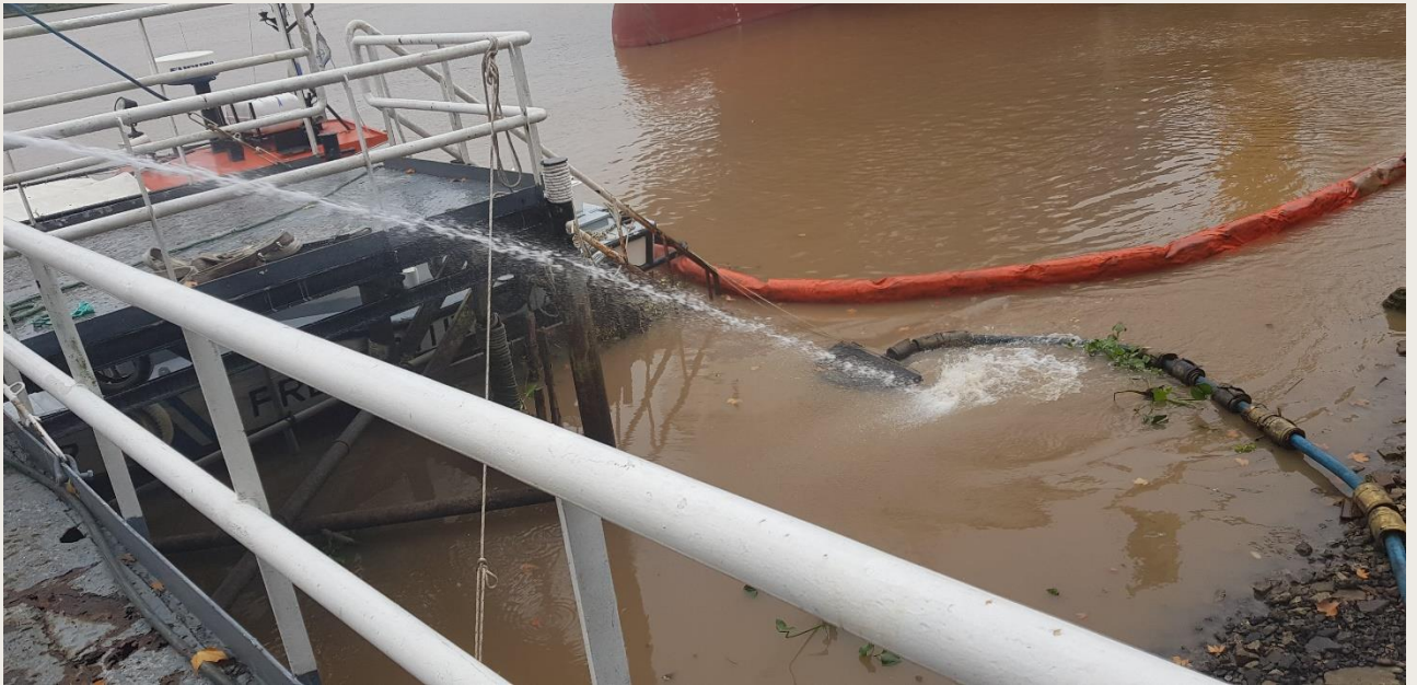
Tendido de la barrera de contención del hidrocarburo y de la línea de manguera con el colector Mantaray para succionar el hidrocarburo sobre la superficie del agua a través de la bomba de succión y llevado hasta el Faxtank
